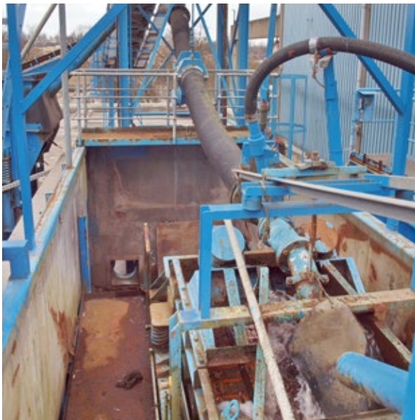
Herzstück der Vertikalsetzmaschine für die Wäsche von Hausmüllasche.
